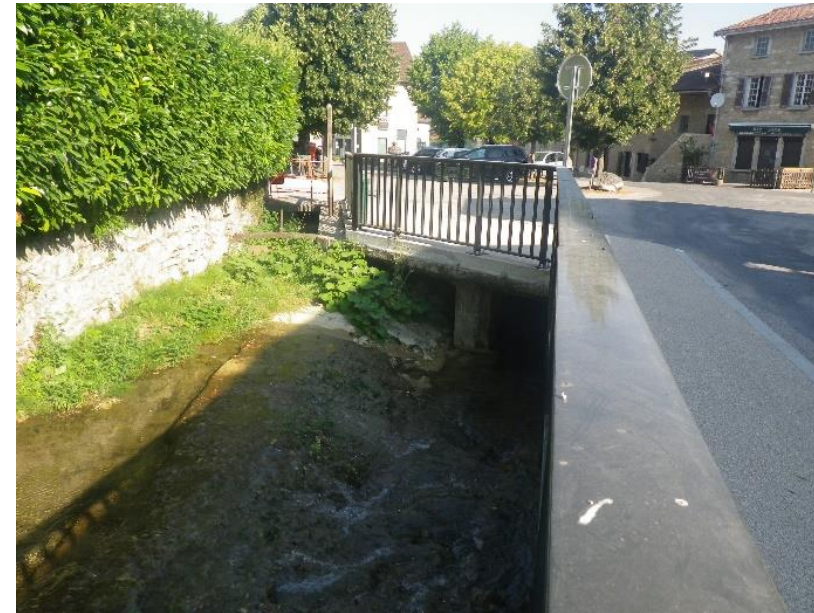
Passage de la Cozance sous la route de la place de la mairie
